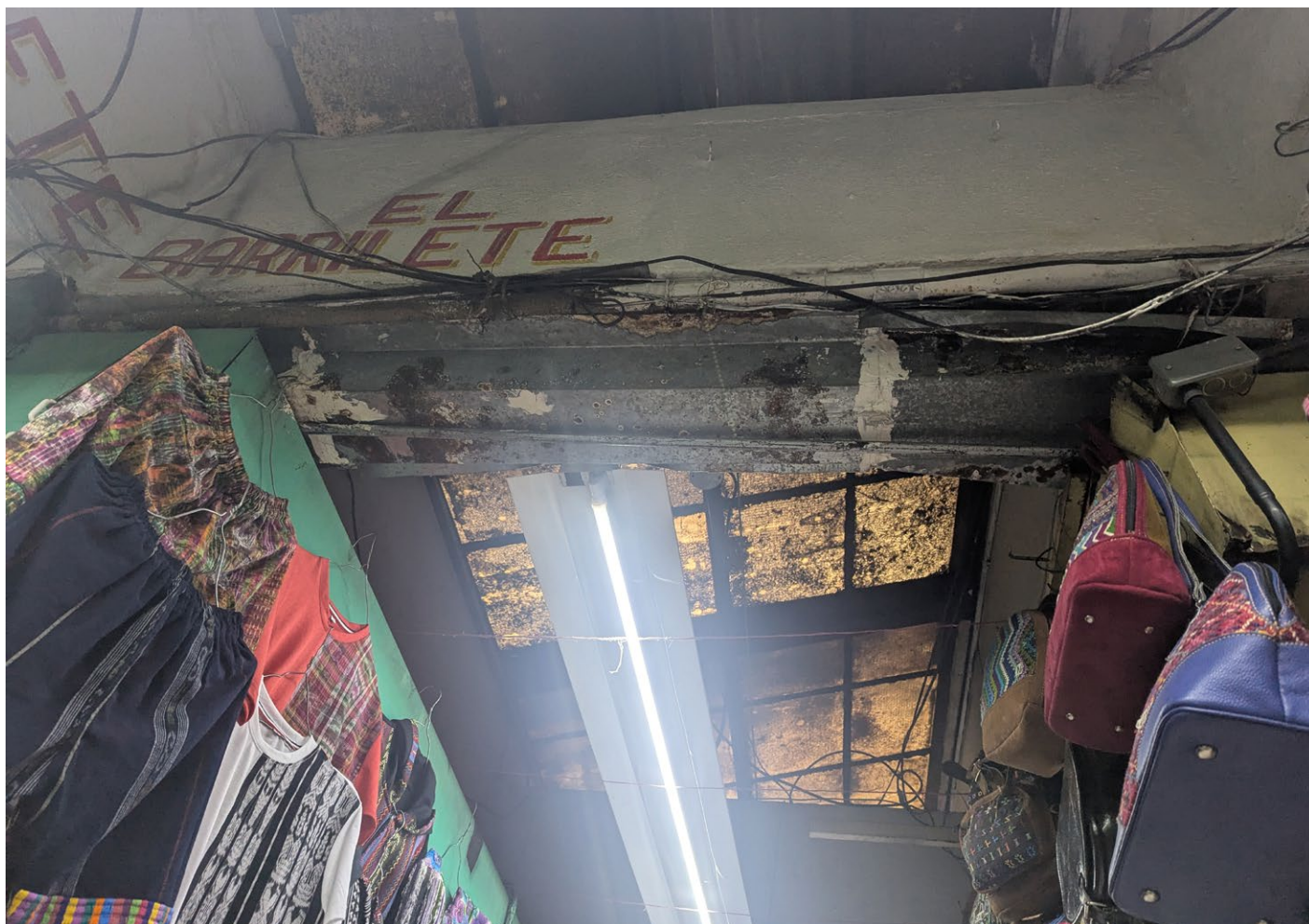
Deterioro y señales de humedad en la infraestructura del Mercado Central, visibles en la estructura del techo del pasillo comercial. Foto: Roxanne Cabrera.
